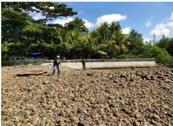
Gambar 7. Struktur pertahanan pantai yang dibangun tidak utuh di Tawiri. Foto bulan Maret 2022.
